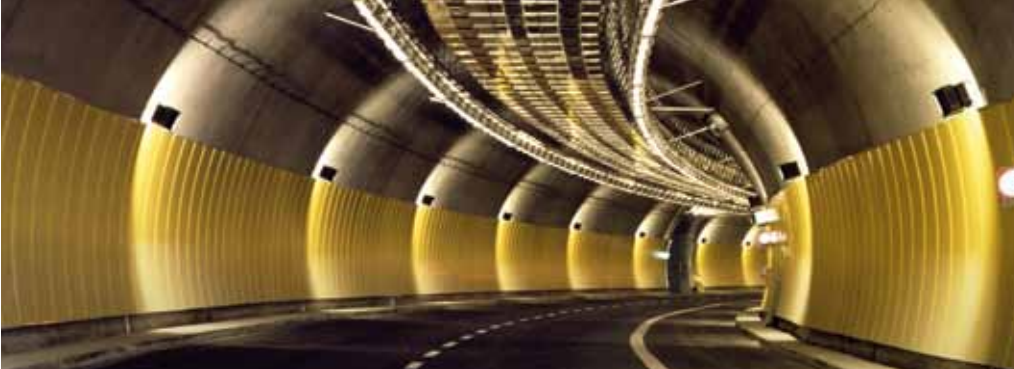
L'acier inoxydable prélaqué est employé en revêtement anticorrosion de tunnels, où il sert à éviter les phénomènes d'éblouissement. Photo : ThyssenKrupp Acciai Speciali Terni, Terni (I)
