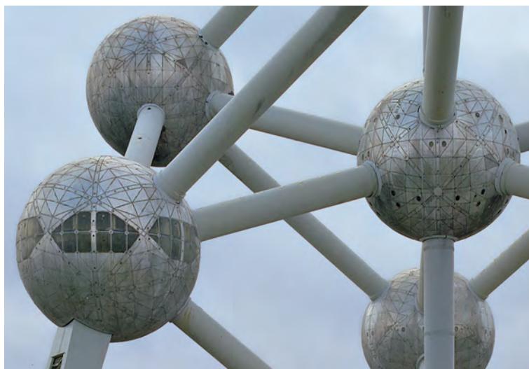
Plus de 40 ans après, les panneaux d'aluminium des sphères avaient perdu leur éclat et les joints n'étaient plus étanches.
