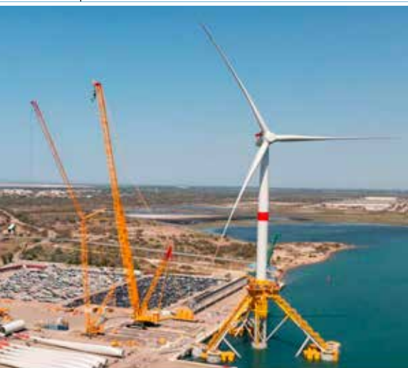
Montage van de windmolen op de floater aan de kade _Montage de l'éolienne sur le flotteur à quai
